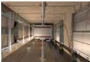
Výťahové vodiace koľajnice
