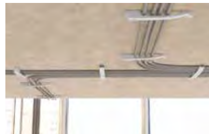
Upevnenie káblových zväzkov
