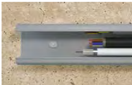
Upevňovanie káblových žlabov
