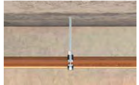
Zavesenie jednotlivých potrubí
