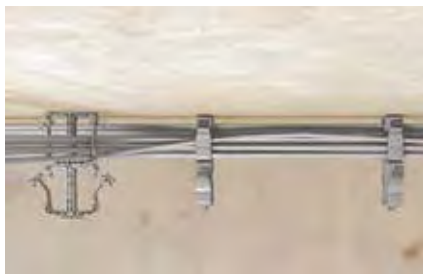
Upevnenie zväzkov káblov
